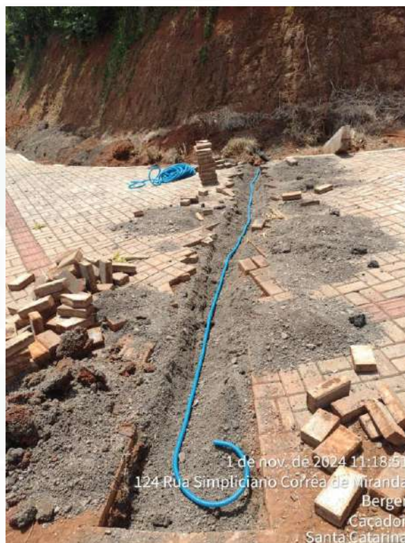
1 de nov. de 2024 11:18:51 124 Rua Simplício Corrêa de Miranda Berger Caçador Santa Catarina Serviços de lançamento de eletrodutos na obra de instalação pública do Parque Linear, realizado pelo Consórcio TS Prisma, em Caçador/SC
