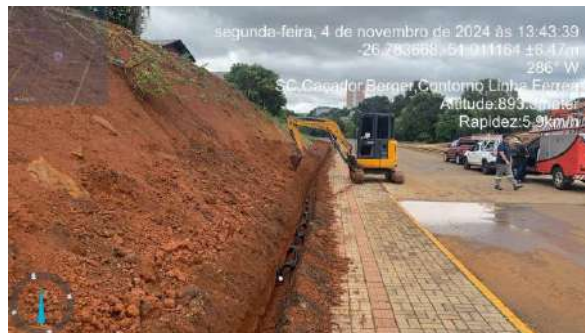
segunda-feira, 4 de novembro de 2024 às 13:43:39 -26.783668,-51.011164 ±8.47m 286° W SC, Caçador, Berger, Contorno, Linha Ferreira Altitude: 893.31meter Rapidez: 5.9km/h Serviços de lançamento de eletrodutos na obra de instalação pública do Parque Linear, realizado pelo Consórcio TS Prisma, em Caçador/SC
